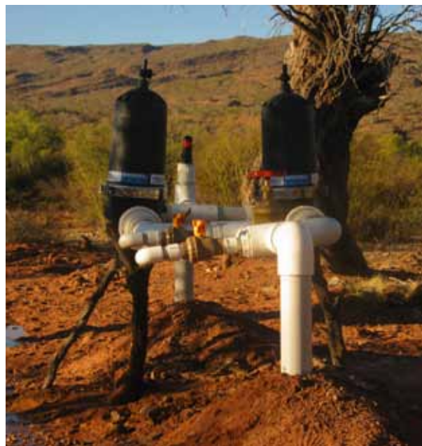
Foto 2: Filtro instalado para la captación y distribución de agua para riego.
