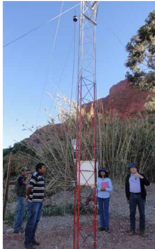
Foto 4: Sistema de Alerta Temprana instalado en el municipio de Las Carreras.
