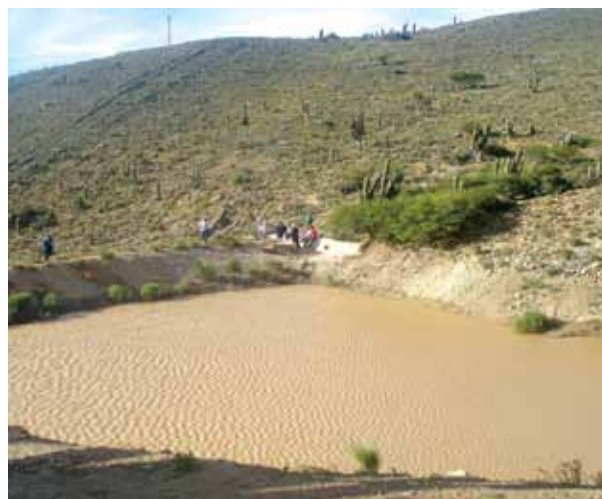
Foto 18: Atajado construido para cosechar agua de lluvias y de las vertientes en El Puente.
